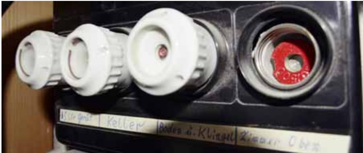
EINE ZÄHLERTAFEL aus Bakelit mit vier Sicherungselementen aus der Frühzeit der Elektrifizierung.
