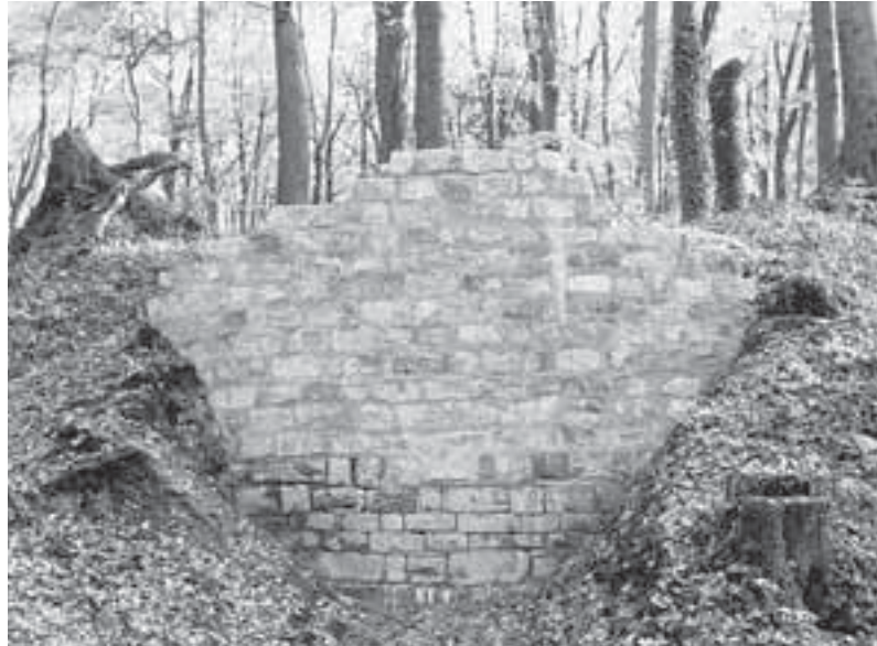
DIE AUFMAUERUNG des massiven Rundturms nach Fertigstellung im November 2009. Um das Originalmauerwerk deutlich sichtbar von der Rekonstruktion zu trennen, wurde ein Bleiband zwischen den Originalbestand und das ergänzte Mauerwerk gelegt. Foto: André Schmalkuche
